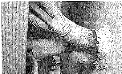
写真6 エアコン配管の設置不具合
