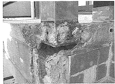
写真5 支柱基部の蓄水
