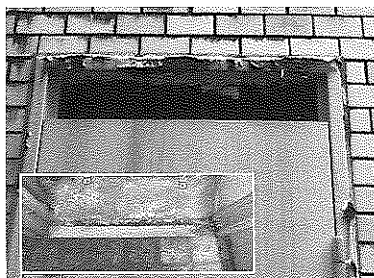
写真1 全体が雨掛り設置で枠の腐食が激しい建具
