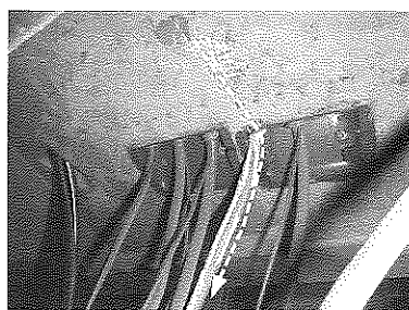
写真3 漏水ルートになったエアコン用コンセントにつながる打込み電線管
