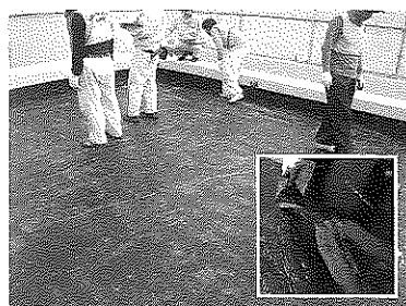
写真6 既存防水撤去直後のひび割れ調査
