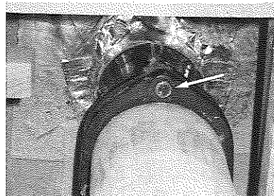
写真4 締付け不良があった排水管継手のフランジ部締付けボルト
