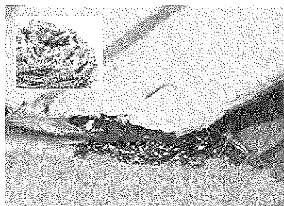
写真4 タワシのカール状ステンレスで屋根と化粧破風の水抜き穴を処理
