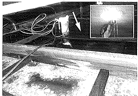
写真3 漏水でプールになった天井内(矢印)
