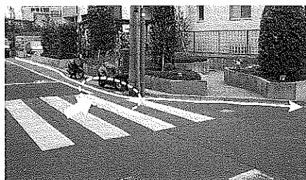
写真2 矢印円内部分を低くすると滞留水は解消する
