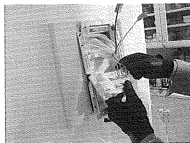
写真2 親機設置台座裏穴と配線をつなぐ防虫ネット
