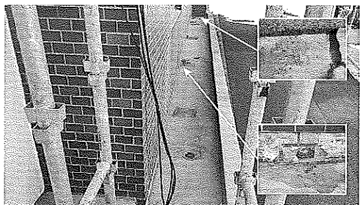
写真3 暴露により外壁の下地に潜った雨水を確認
