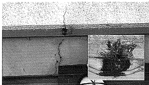
写真1 常時水滴が垂れ落ち、苔の繁殖がある上げ裏の漏水部
