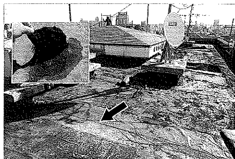
写真-3 緑化部下は、耐根シートではなく、除草シート
