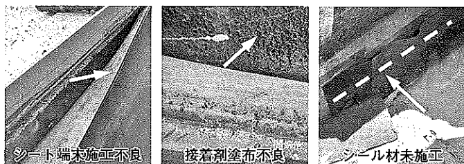
写真-3 立上り端部・平場納まりの施工不良
