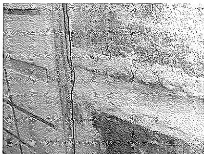
写真-2 調整モルタルが塗られた打継ぎ目地
