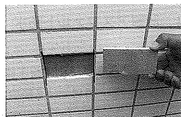
写真-3 左下半分がサンダーカットされていない破断面
