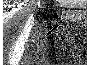
写真-9 屋上緑化による防水層のしわ寄せと損傷劣化
