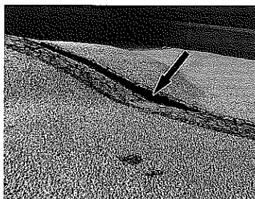
写真-1 防水層のふくれと口開き
