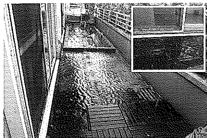
写真-1 冠水した床。水位は、サッシ下枠水切りまで及んだ(右上)
