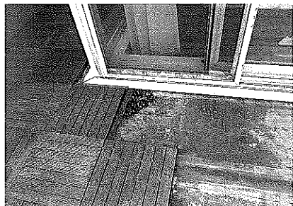
写真-3 止水処理が困難な納まり
