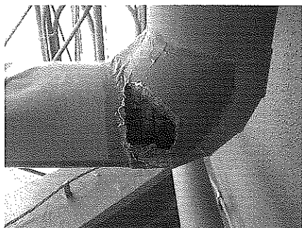
写真-4 補修判断を誤り、ラッキング材腐食部補修にとどめた
