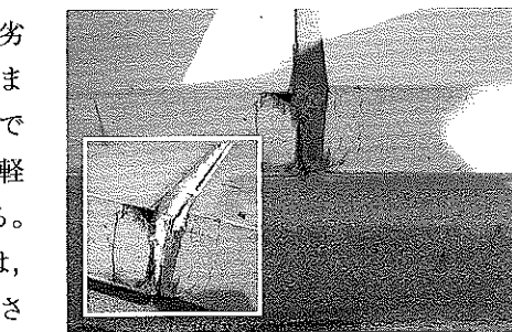
写真-2 基礎天端つなぎ目5mm程度の隙間とシーリングの肌別れ
