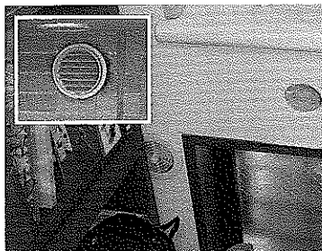
写真-2 配管スペースを介して設置された給気口。左上は、外部給気口
