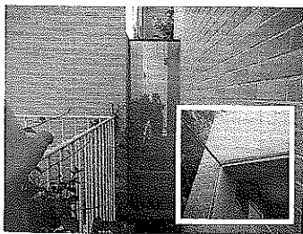
写真-2 漏水原因となったガラス渡り廊下部分
