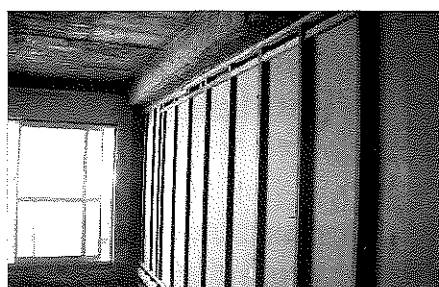
写真2 2次取得者が隣戸の界壁を撤去してむき出しになった壁下地
