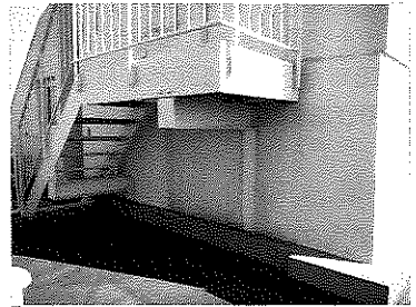
写真1：処理が必要な鉄骨階段ササラ鋼板と躯体の隙間
