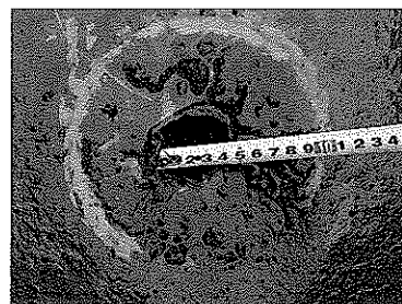
写真-2 2サイズ小さい改修用ドレンを設置した不良事例
