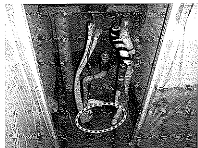
写真-3 問題箇所となった給湯器下の床
