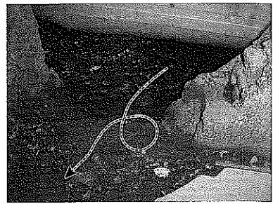
写真-1 排水管の口径不足による漏水
