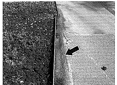
写真-5 緑化部の縁に発生した露出防水層の浮き上がりよじれ
