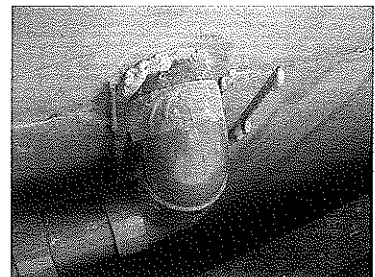
写真-2 発泡ウレタン樹脂による貫通部周囲の隙間止水処理
