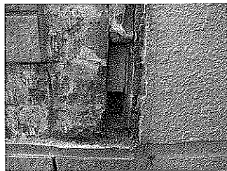
写真-2 構造スリットと水平打継ぎ目地直交部の空洞
