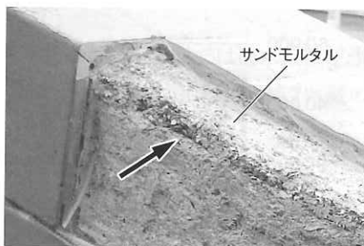
写真3 雨水の流動ルートとなった天端のならしで塗ったサンドモルタル
