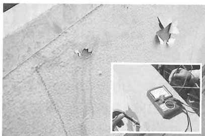
写真2 電気抵抗試験によりタイル化粧目地から雨水の浸透を確認
