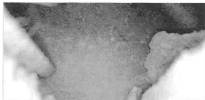
写真3 内視鏡カメラで確認した建具枠内部の空洞の状態
