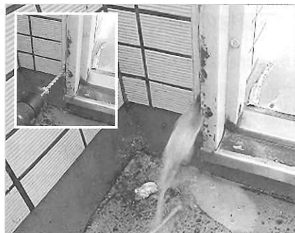
写真2 ドリル穿孔により内部から水が噴き出した建具枠外側
