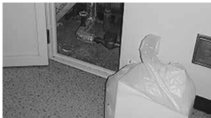
写真4 扉を半開きにして使用していたメーターボックスとゴミ袋(手前)
