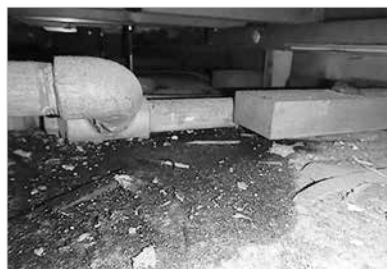
写真2 確認できた上階床下の水濡れ
