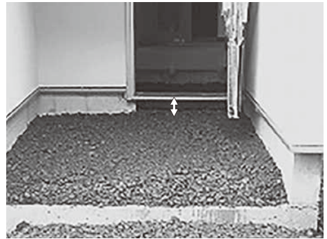
写真1 玄関扉の取付け後、相当な期間開いたままになる枠下の隙間
