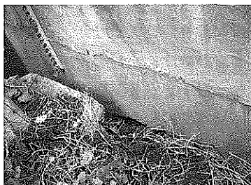
写真-2 床版先端部の陥没地盤沈下
