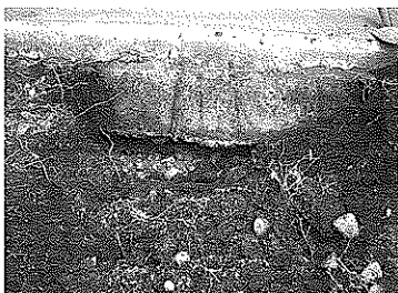
写真-3 床版裏の沈下空洞
