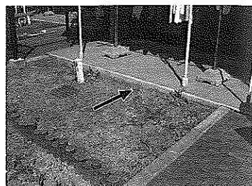
写真-1 床版先端部の地盤沈下とコンクリート土間の暴れ
