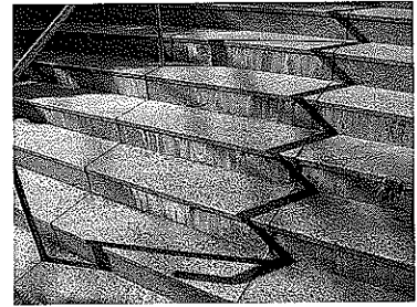
写真-1 汚損が目立つ外部階段
